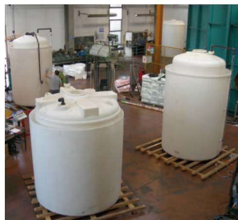
Cisterne con vasca di raccolta Tanks with secondary containment
